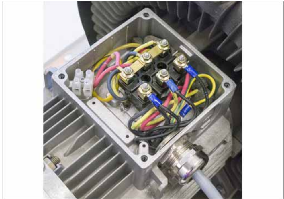
Cablaggio della morsettiera motore
