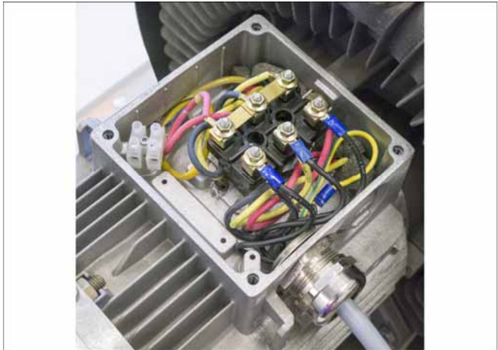
Cablaggio della morsettiera motore
